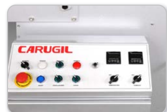
Panel de control para monitorizar el proceso (humedad y temperatura dentro del túnel).
